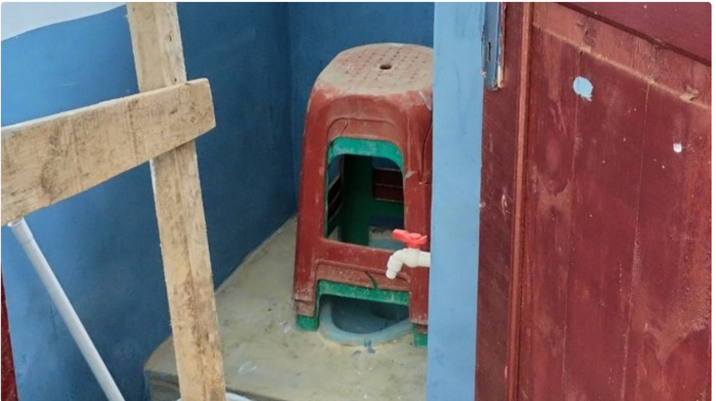
Kondisi toilet (jamban) SMPN Satap 1 Dolat Rakyat, Kecamatan Dolat Rakyat, Kabupaten Karo seharga Rp.169 juta
